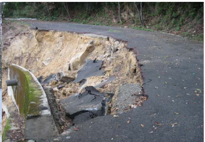
呉市 渡子藤の脇線 (路肩) 崩壊
