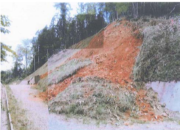
三次市 黒鞆線 (法面崩壊)
