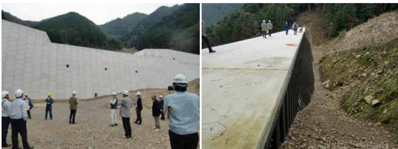
ソイルセメント谷止工(L=133.0m、H=14.0m)、下流側はコンクリートブロック、上流側は軽量鋼矢板
