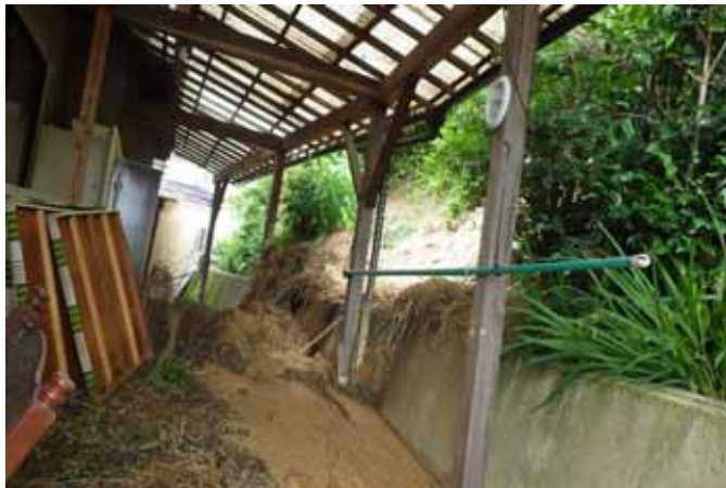
小規模崩壊地復旧事業計画地（尾道市神田町）
