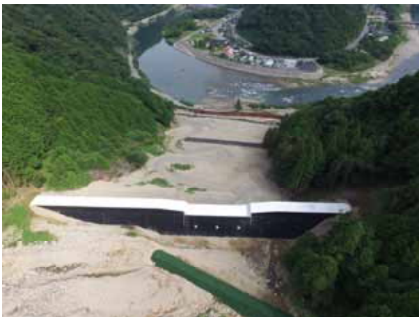
「災害復旧工事ソイルセメント谷止工」 (場所:広島市安佐南区八木 撮影者:田村孝治)
